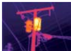
Перегретый полюс трансформатора
