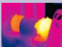
Перегрев крышки подшипника
